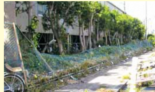
施設を囲むフェンスが倒れている様子
