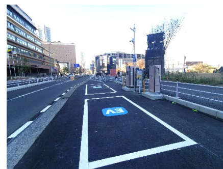
EV用公道充電器 (新港中央広場)
