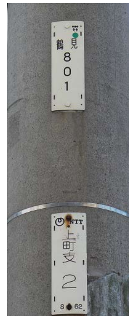
東京電力も使用しているNTT柱
