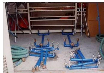
応急給水装置 (配管類)
