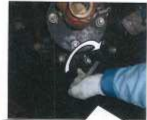
5-② 給水栓の下に設置されている補 修弁を開けます。 (レバーを右側へ45度倒し、O(OPEN) の表示に合わせます。)
