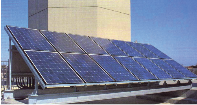
太陽光発電パネル（北山田小学校）
