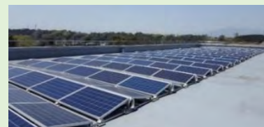
屋上を利用した太陽光発電設備の設置
