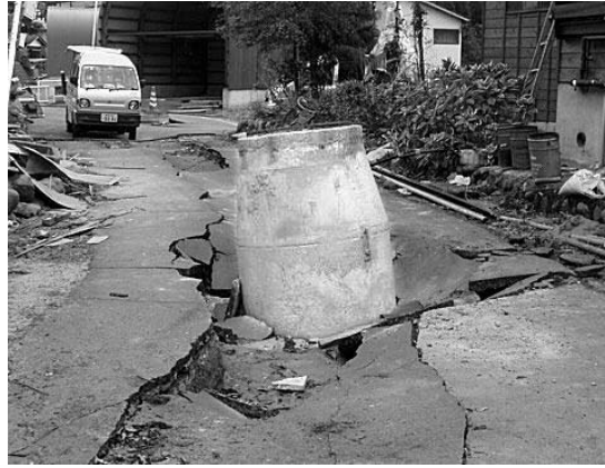
図1.1.1.2 地震の影響で浮上したマンホール（新潟県中越地震）
