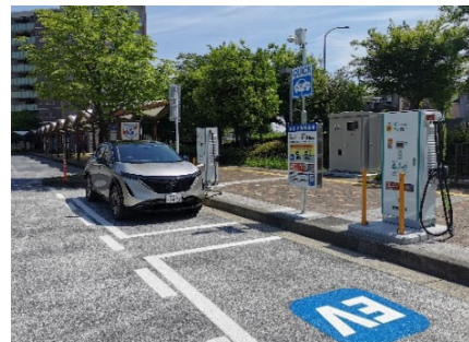
センター南駅前広場において、公道上にEV用充電器を設置
