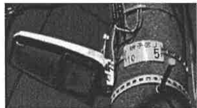
図表27 電柱共架型防犯灯
