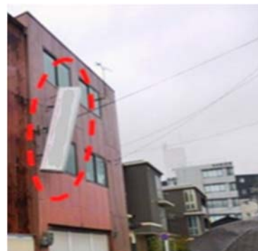
【強風により看板の金具が外れて傾いている状況】
