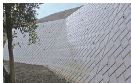
危険な崖の改善例
