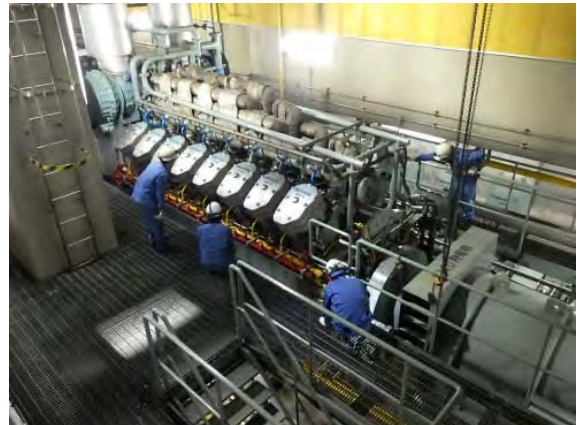
自家発電機設備の点検
