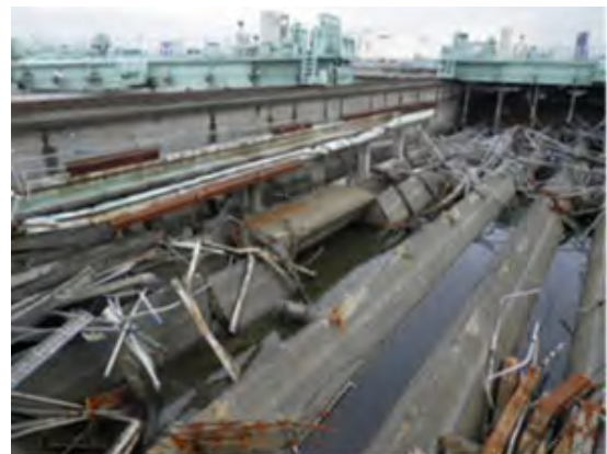
2011（平成23）年 東日本大震災被害状況（施設）
