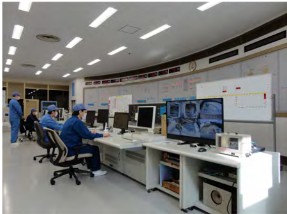
中央操作室での運転管理
