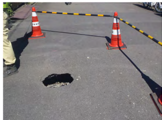
取付管破損による道路陥没
