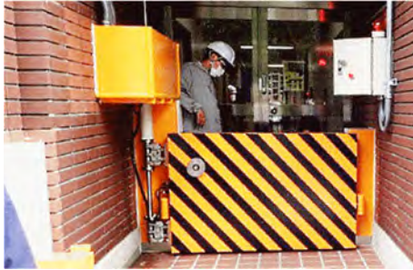
建物の耐水化（防水扉）
