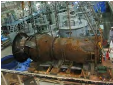
再整備前のポンプ設備
