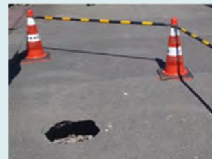
取付管破損による道路陥没
