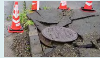
マンホール浮上被害状況
