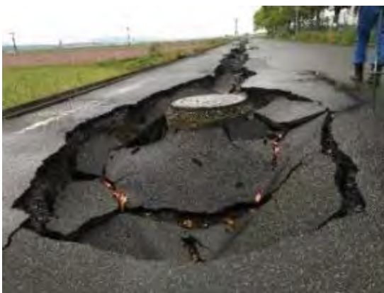
2016（平成28）年 熊本地震被害状況（下水道管）
