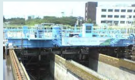
最終沈殿池の採泥機
