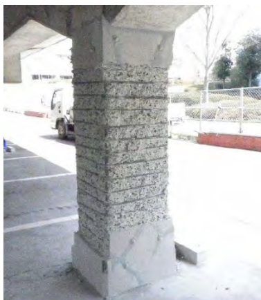
震災で損傷した高架橋柱（提供：仙台市） （剥落の恐れがある表面を修復途中で落とした状態）
