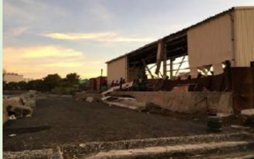
令和元年度台風15号の際の建物の全壊の様子
