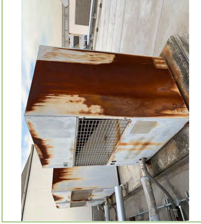
現況写真①（空調設備）
