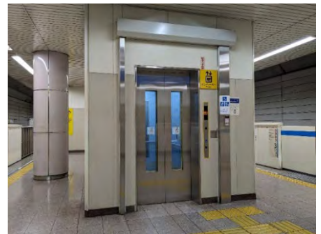
駅構内エレベーター（中田駅）
