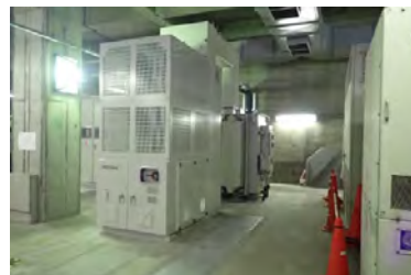
変電所機器・変圧整流設備
