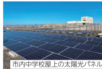
市内中学校屋上の太陽光パネル
